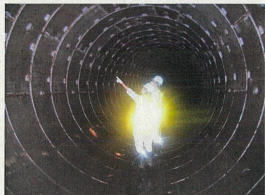
雨水トンネル（石田川1号幹線）
